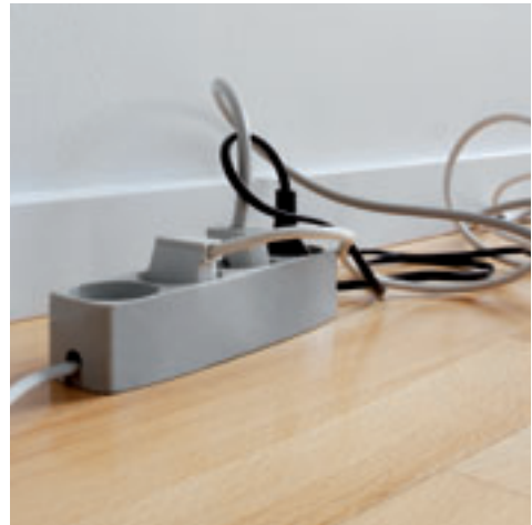
Overskydende forlængerledning bør afkortes.
