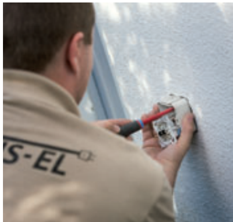
Udendørs el-materiel skal installeres og udskiftes af en autoriseret el-installatør.
