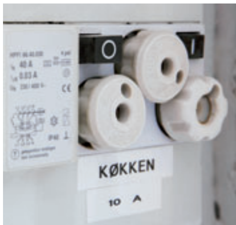
Gammeldags sikringer, hvor porcelænsfatningen skrues ud, når sikringen skiftes.
