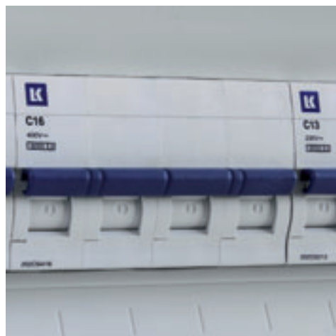
Automatsikringer kobler ud ved fejl et sted i gruppen.
